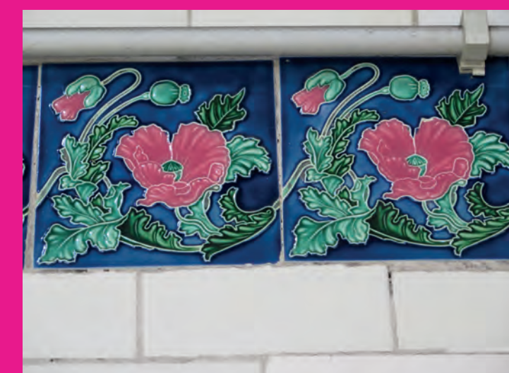
Carreaux de céramique de la cuisine.
