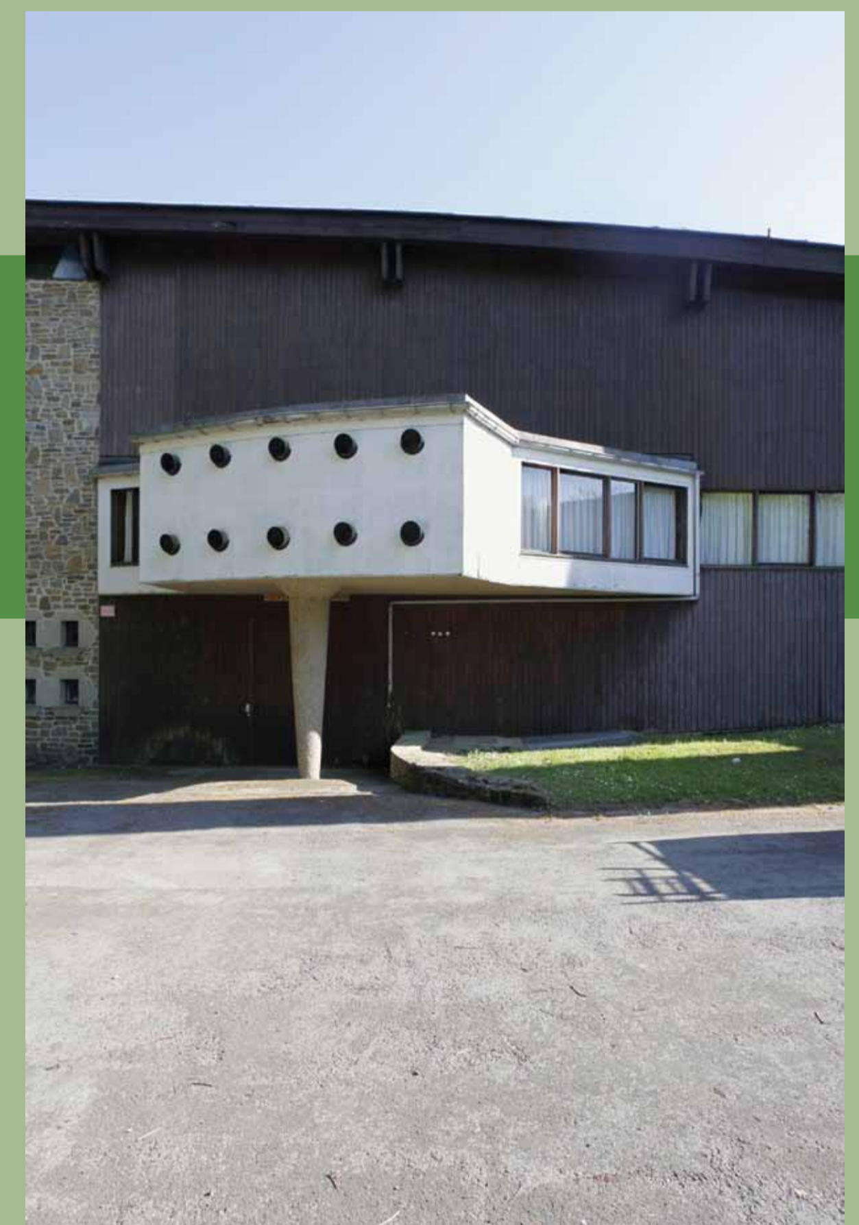
3 Façade nord - © MN Dailly Ce petit volume suspendu abrite le local technique de la salle de spectacle et crée un effet expressionniste.
