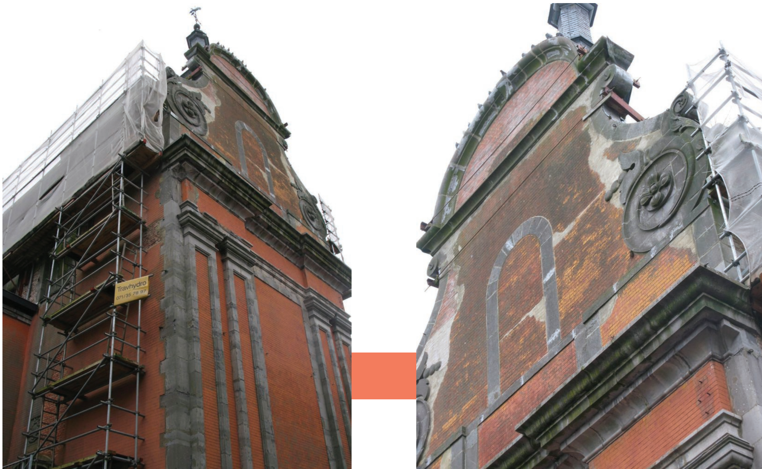
Chapelle des Soeurs Grises : la façade dégradée avant restauration.
